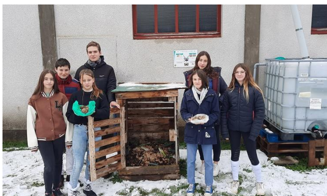
Installation du nouveau composteur et du récupérateur d'eau.
